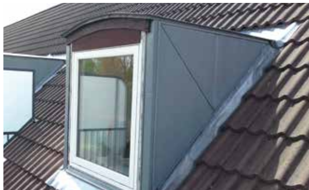
De gamle kviste er udført forkert i zinkbeklædninger, således at de er utætte og under opløsning, hvis der ikke gribes ind.
