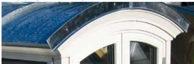
Buet vindue og gesimsliste
