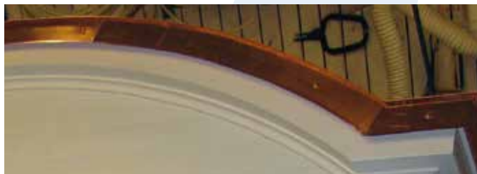
Knæk på tag, bræddespejl og gesimsliste
